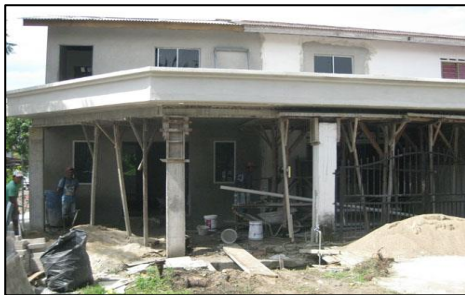
Taman Mentakab Indah, Temerloh - Penambahan Ruang Bangunan Tanpa Kelulusan (07.09.2016)
