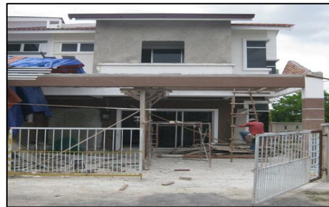
Jalan Rimba Permai 1/5, Temerloh - Penambahan Ruang Bangunan Tanpa Kelulusan (07.09.2016)
