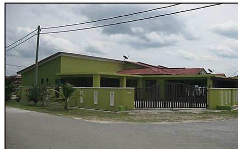
Taman Nusa Puteri, Rompin - Penambahan Ruang Bangunan Tanpa Kelulusan (12.10.2016)
