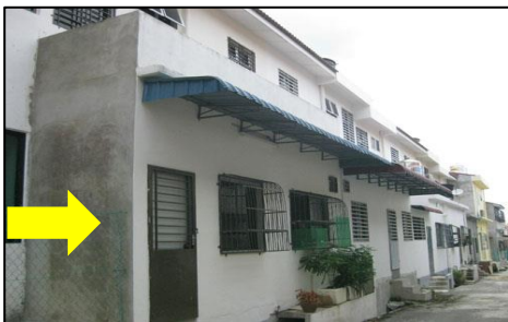
Taman Rimba Permai, Temerloh - Penambahan Ruang Bangunan Tidak Mengikut Pelan dan Belum Dinilai Semula (07.09.2016)
